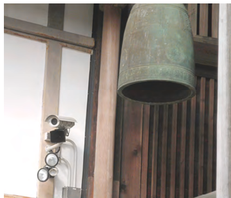
御影堂と如来堂をつなぐ通路(屋外)にも、カメラ(ハウジング入り)と赤外線照明器を設置
