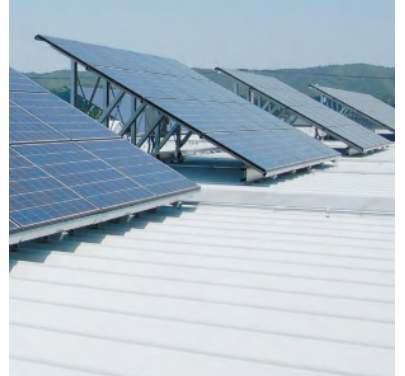
発電設備 宮城工場
