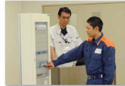
●初めて火災受信機に触れる緊張の瞬間。
